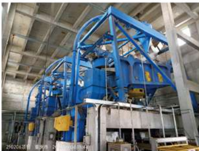
木片筛 (1000m 3 /h, 700m 3 /h) + 再碎机 (110m 3 /h)
